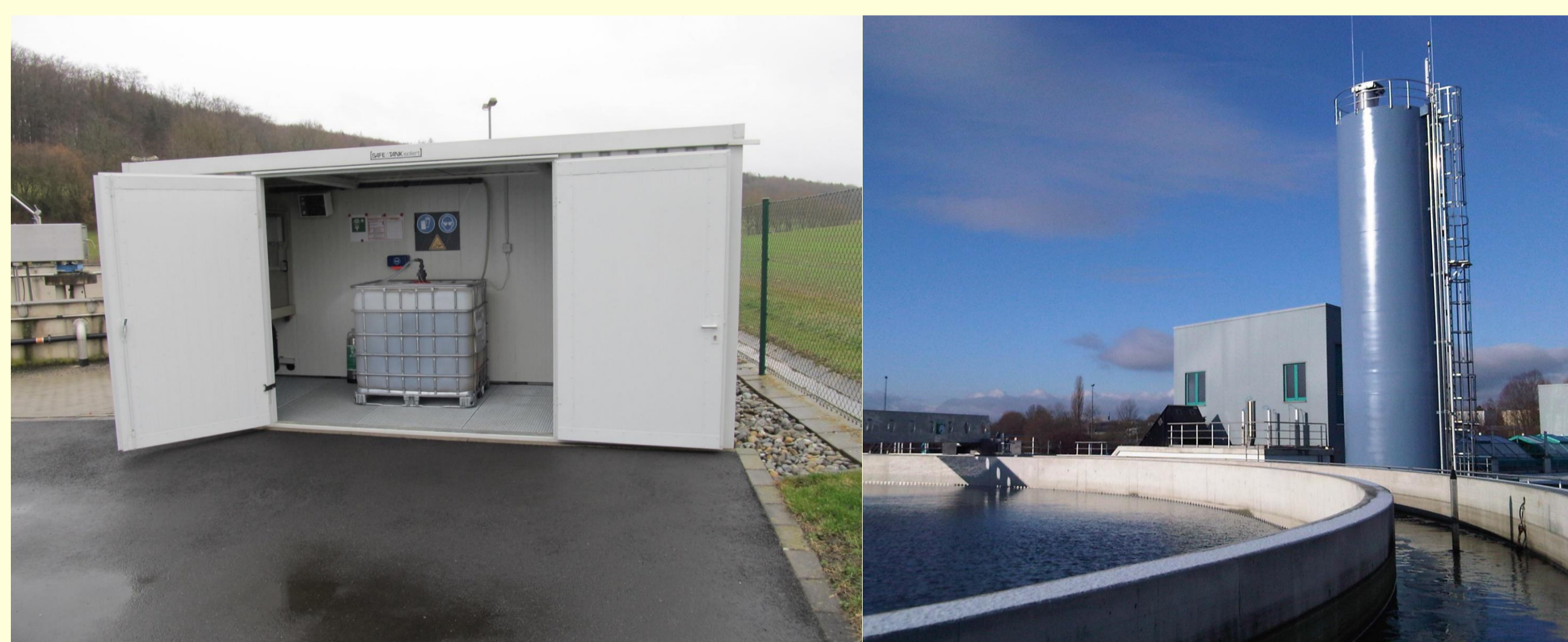
Abbildung 3: links: Fällmittelstation auf einer Kläranlage (Fällungsvariante), rechts: Filteranlage (im Hintergrund) auf einer Kläranlage (Filtervariante)
