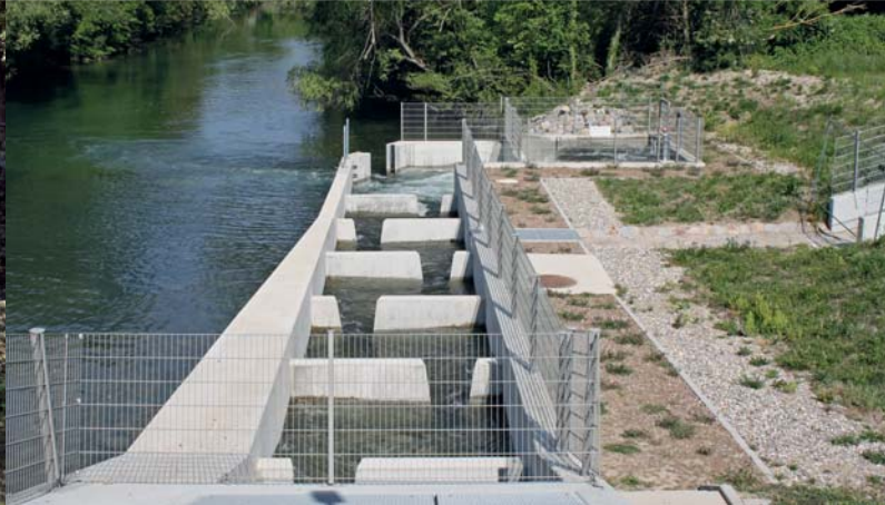
Becken der Fischtreppe Möhlinwehr
