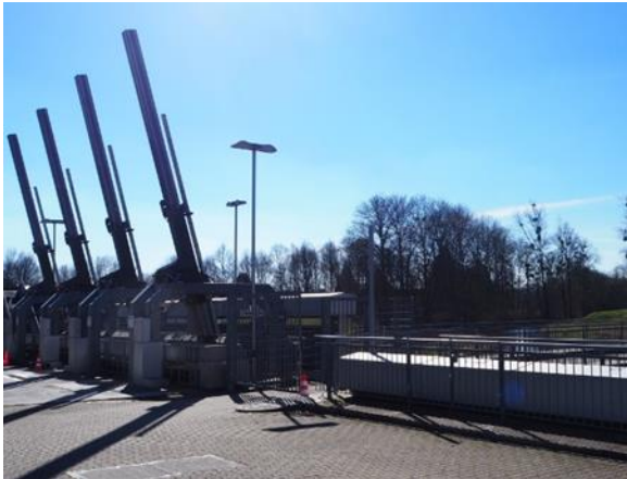
Abb.15: Die Rechenreinigungsanlage des Acherschöpfwerk
