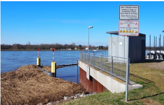
Abb.19: Das Rheinwasserentnahmebauwerk N
